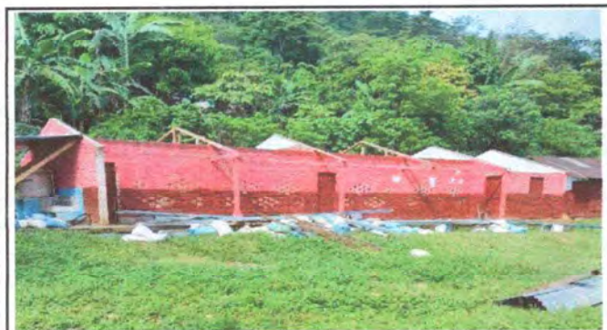
Foto 3: Se evidencia la desmantelación del anterior techo con el que contaba la escuela
